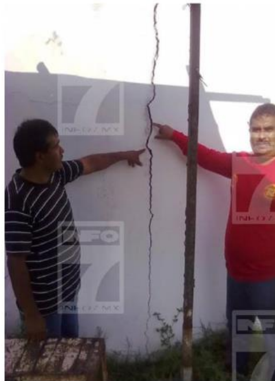
Daños en casa habitación en General Terán, N.L.
